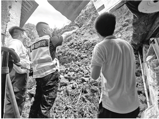
丽水局莲都分局会同“驻县进乡”地质队员对莲都区雅溪镇岩寮村滑坡隐患开展应急调查。
